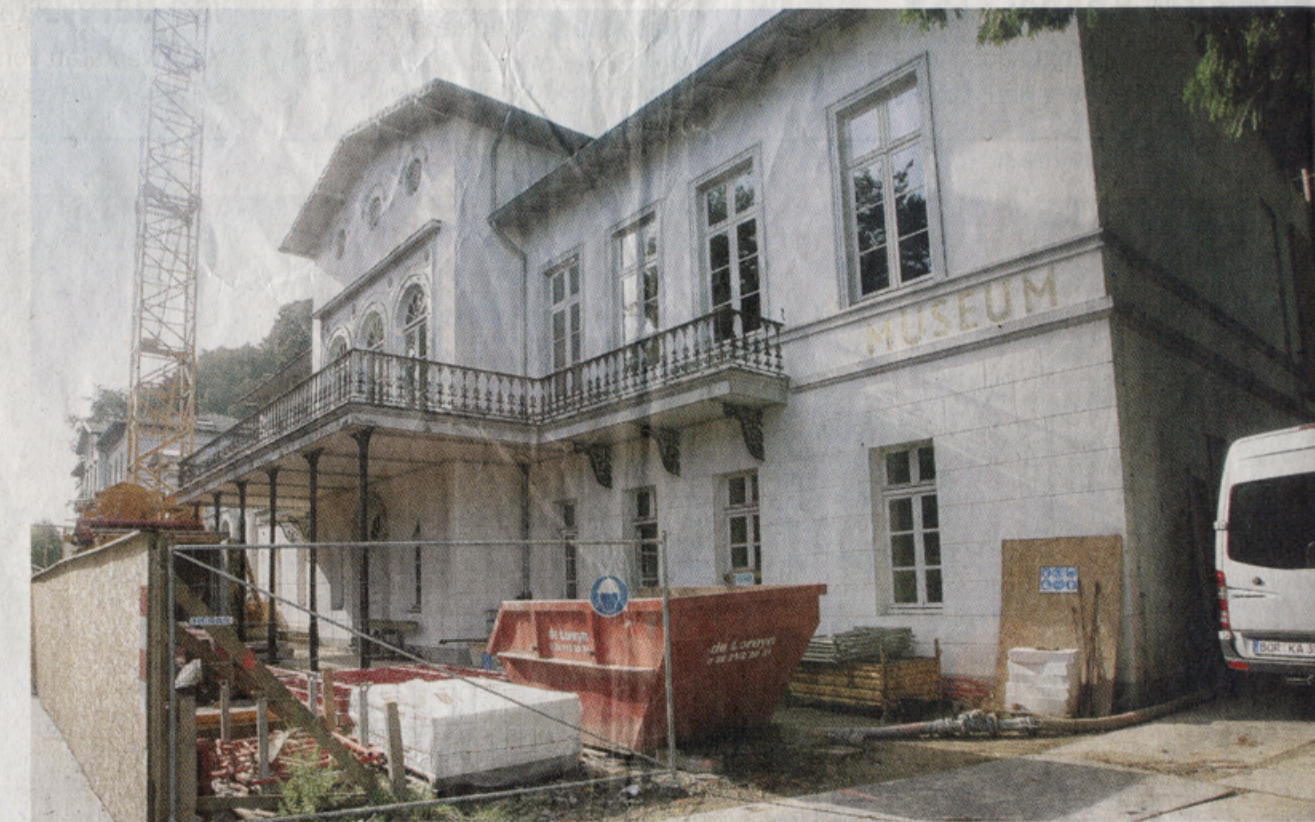
Auf engstem Raum wird am Museum Kurhaus in Kleve gebaut. Schwierig war der Bau eines Kellers.
